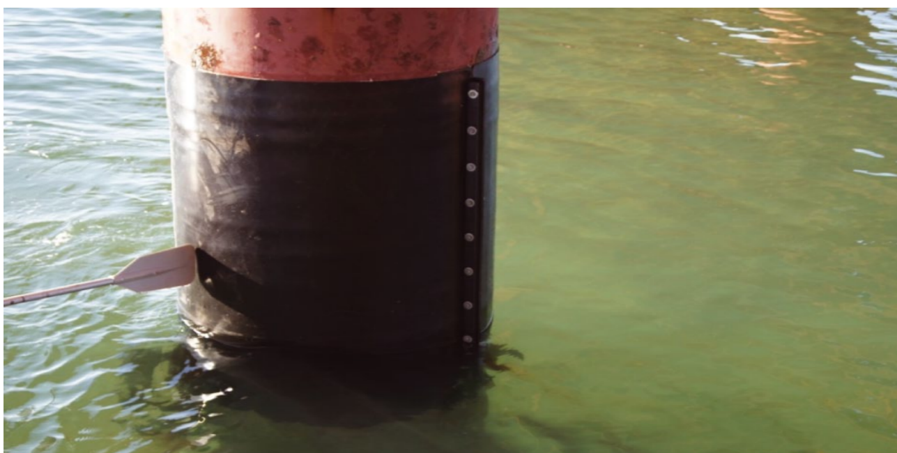
Рис. 11. Система MarineProtect®-2000FD после монтажа
