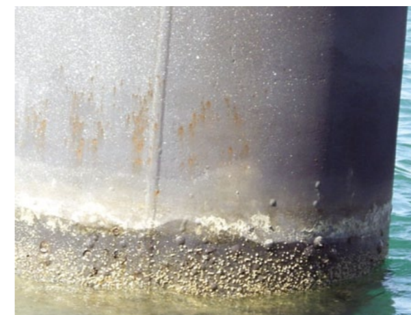
а). Разрушение покрытия в зоне переменного смачивания. Срок эксплуатации 1 год
