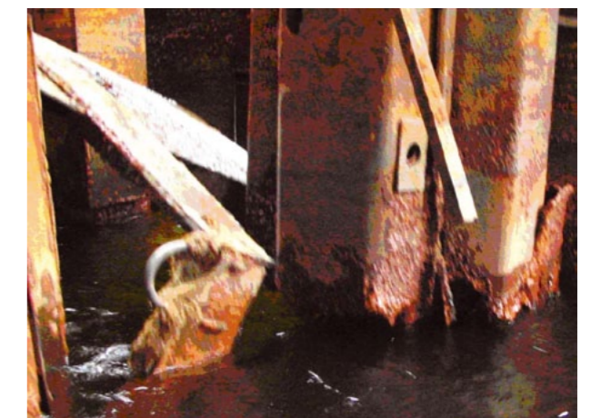
г). Разрушение покрытия в зоне забрызгивания и переменного смачивания. Срок эксплуатации 15 лет
