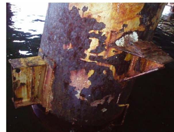
в). Разрушение покрытия в зоне забрызгивания. Срок эксплуатации 8 лет
